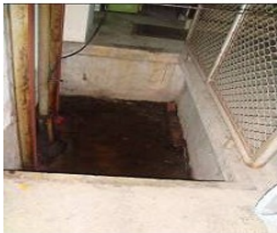
地下室之升降梯孔積水
