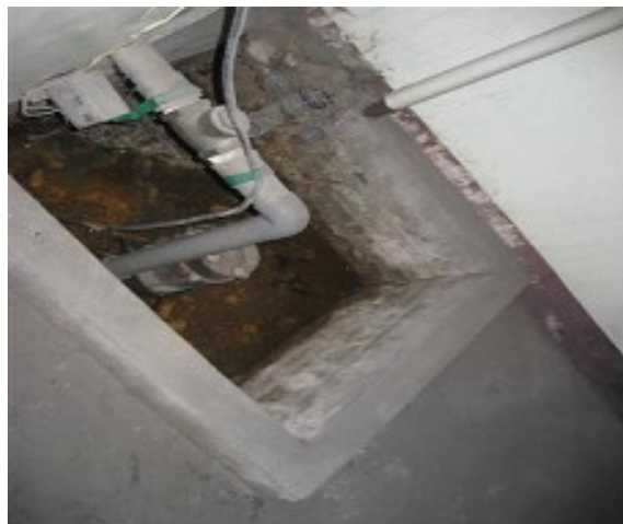
地下室儲水槽
