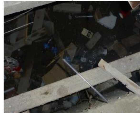
建築工地廢棄物堆積處
